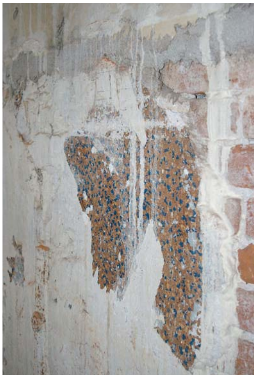
Afb. 36 Gebouw 1. Detail van het stucwerk van de oostelijke zijmuur op de verdieping met sporen van een vermoedelijk laat-19de-eeuwse lambrisering in imitatie-granito (in spattechniek).
