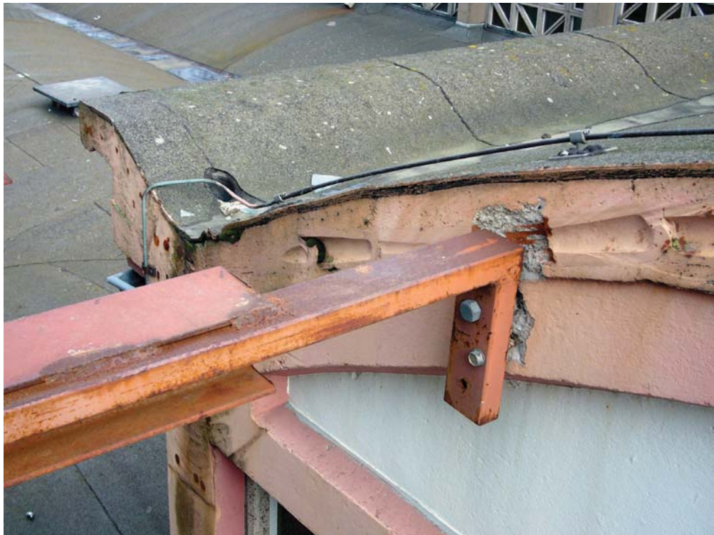
Afb. 27 Arnhem, treinstation uit 1954. Detail van doorgesneden randbalk. (Foto R. Stenvert, 2007)
