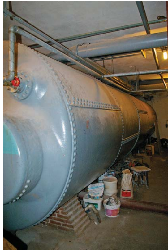
Afb. 56 Gebouw 6. In het oorspronkelijk laat-19de-eeuwse ketelhuis staat een ketel opgesteld met het opschrift ' nr. 77, Jan F. Meursing Amsterdam 1907 '. Deze stoomketel werd kort na de oorlog omgebouwd en in gebruik genomen als waterreservoir voor de sprinklerinstallatie.
