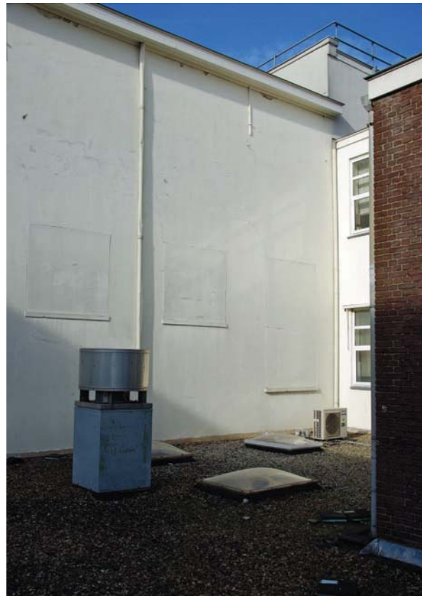
Afb. 62 Deel van de zuidgevel van de Grote Zaal met daarin dichtgezette ramen en (nood)deuren. De witte pleisterlaag verhult mogelijke oudere sporen uit de weeshuisperiode, dan wel kloosterperiode. Vaag zichtbare boogvormige scheuren kunnen op oudere sporen duiden.
