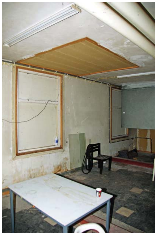
Afb. 79 Ruimte 3.09, gebouwd na 1926 ten behoeve van de luchtbehandeling in de Grote Zaal.
