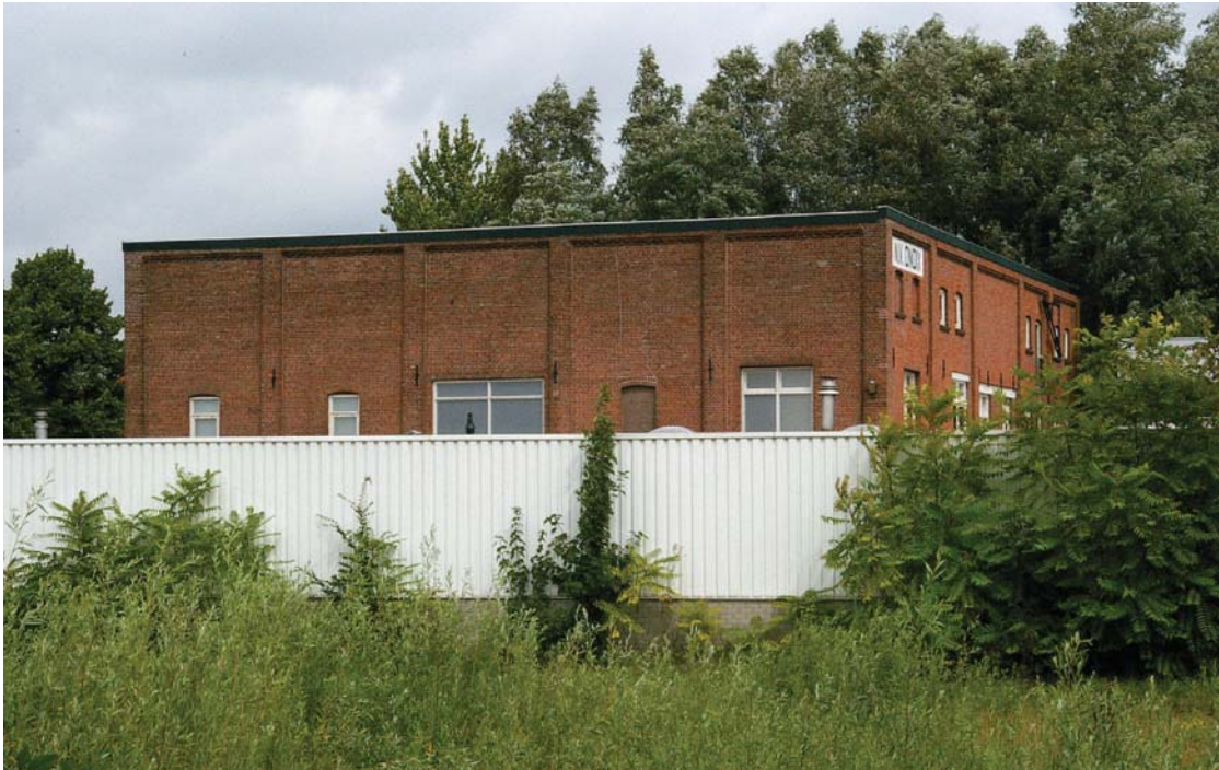
Afb. 20 Het gebouw Ondix (Rotsoord 13) gezien vanuit het zuidoosten. In de zuid- en de oostgevel (voorgevel) bevinden zich nog verschillende oorspronkelijke licht getoogde vensteropeningen, dichtgezet of voorzien van een houten kozijn en raam in plaats van gietijzeren ramen.
