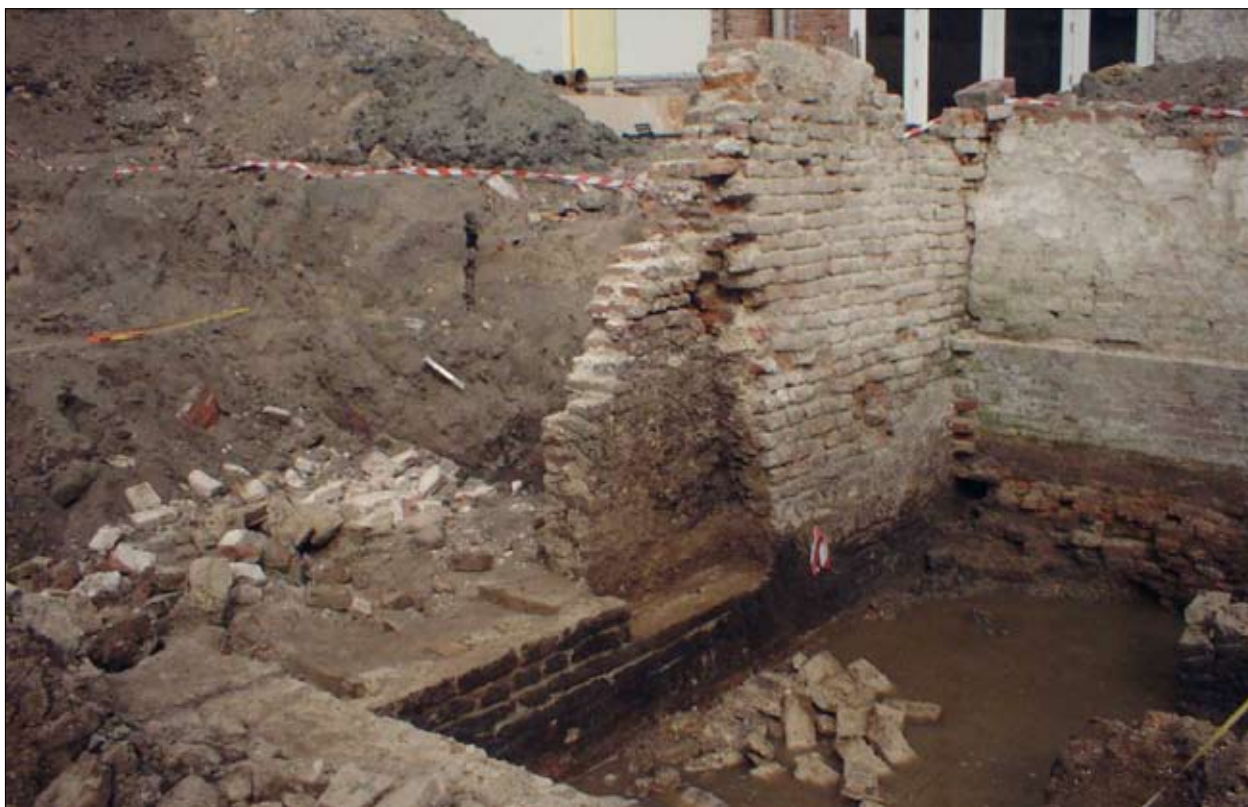
5.24 De doorgang tussen gebouw D (rechts) en gebouw A (links) werd in twee fases dichtgezet. Beide fases zijn kort op elkaar gevolgd. De foto toont de situatie na verwijdering van de vermoedelijke tweede fase. De beeraanslag in de kelder van gebouw D, die vooral prominent aanwezig is op het onderste deel van het muurwerk, is ook te zien in de dichtzetting.
