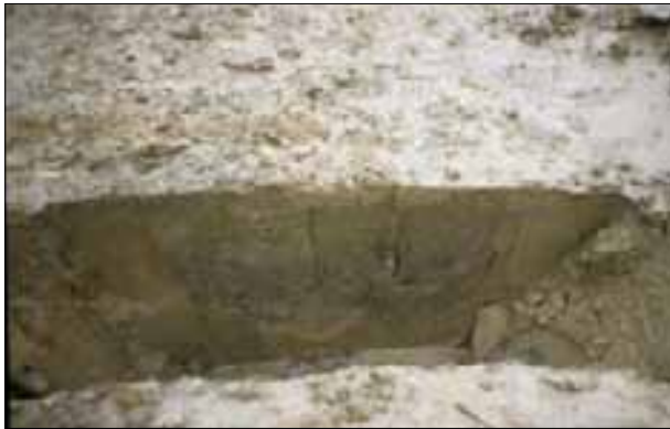
Afb. 5.9 Dat er constructieve problemen moeten zijn geweest (door de natte condities?) blijkt uit het feit dat met name aan de zuid- en zuidoostelijke kant van het huis herstellingen hebben plaatsgevonden: minstens vijf wandstijlen zijn hier vervangen. Op de foto een voorbeeld van een aanwijzing voor herstelling. Links is de oorspronkelijke paalkuil te zien, rechts het recentere exemplaar.
