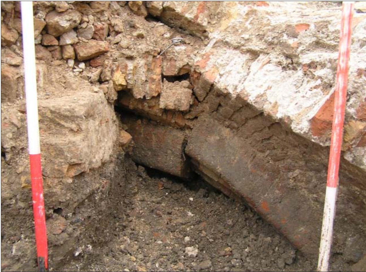
Afb. 4.22: De middelste zuidelijke gewelfrib heeft op een gegeven moment statische problemen gekregen. Het is mogelijk dat dit probleem zich al tijdens de bouw heeft voorgedaan. Ook elders in het gebouw had met men dergelijke zettingproblemen te maken.
