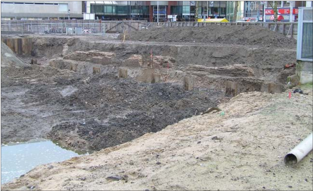
Afb. 4.16: Keermuur tijdens het ontgraven. Zichtbaar zijn verschillende beschadigingen en doorbraken.
