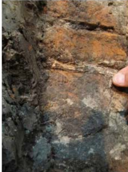
Afbeelding 4 toont aantasting van voegen door boomwortel
