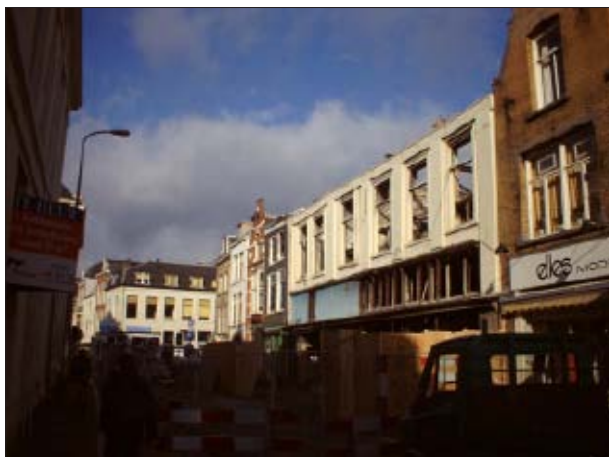
Afb. 3.1 De gehavende voorgevel van het pand Wittevrouwenstraat 10 (wit) na de brand, met daarnaast op de achtergrond het smalle pand Wittevrouwenstraat 8. Ook dit pand ging bij de brand verloren.
