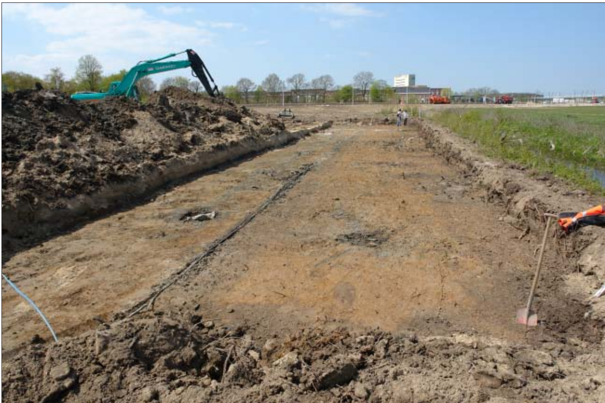
Afb. 3.1 De verstoringen in sleuf 7, gezien richting het westen. Niet alleen de aanleg en het verwijderen van drainagebuizen of kabels, maar vooral grondverzet en deels ook bomen hebben voor schade gezorgd. De laag waarin de sporen zich bevonden is nagenoeg verdwenen.
