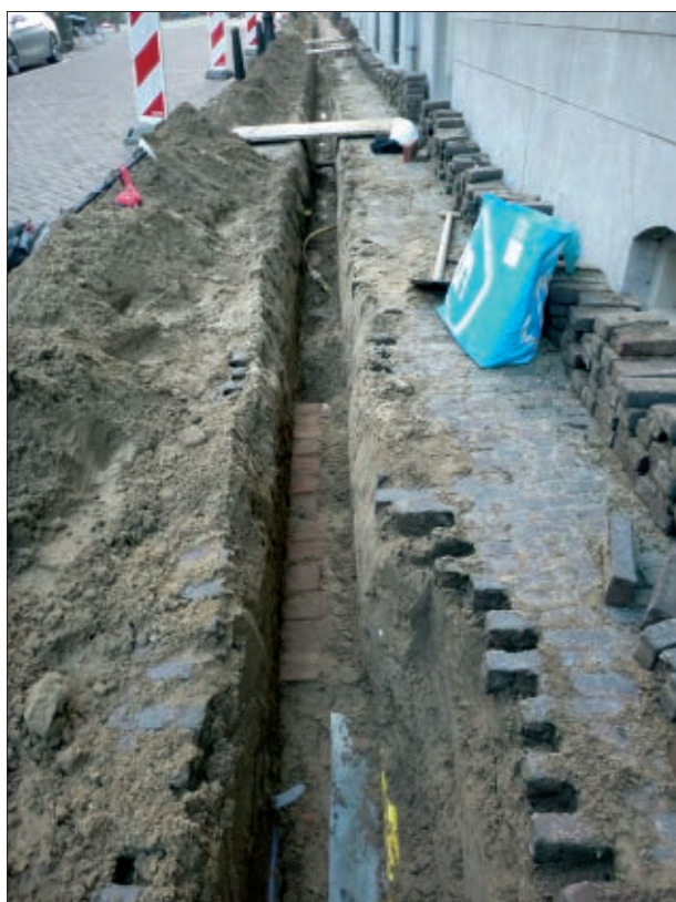
Afb. 4.1 De sleuf in de Voetiusstraat met daarin de baksteenrij die een kabel afdekte. Gezien vanuit het oosten.
