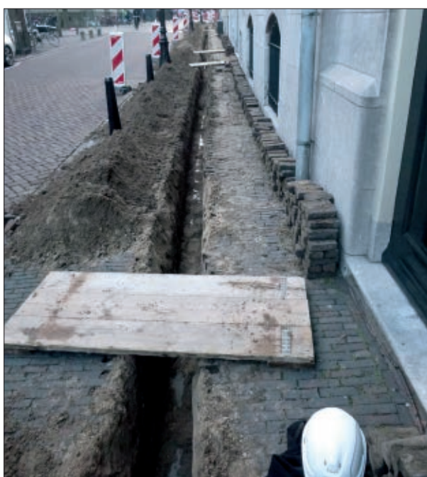
Afb. 4.3 Het tweede gedeelte van de sleuf ter hoogte van de Voetiusstraat. Wederom is duidelijk te zien dat de ondergrond enkel uit schoon zand bestaat. Gezien vanuit het oosten.
