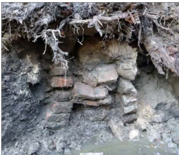
Afb. 4.11 Het riool S12 gefotografeerd naar het westen. Het riool verkeert in slechte staat; vermoedelijk als gevolg van zowel de bouwwijze als de boomwortels erboven.
