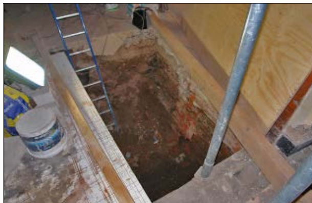
Afb. 3.1 De deels uitgegraven liftschaft zoals aangetroffen bij inspectie op 16-12-2016. De foto is genomen naar het oosten.
