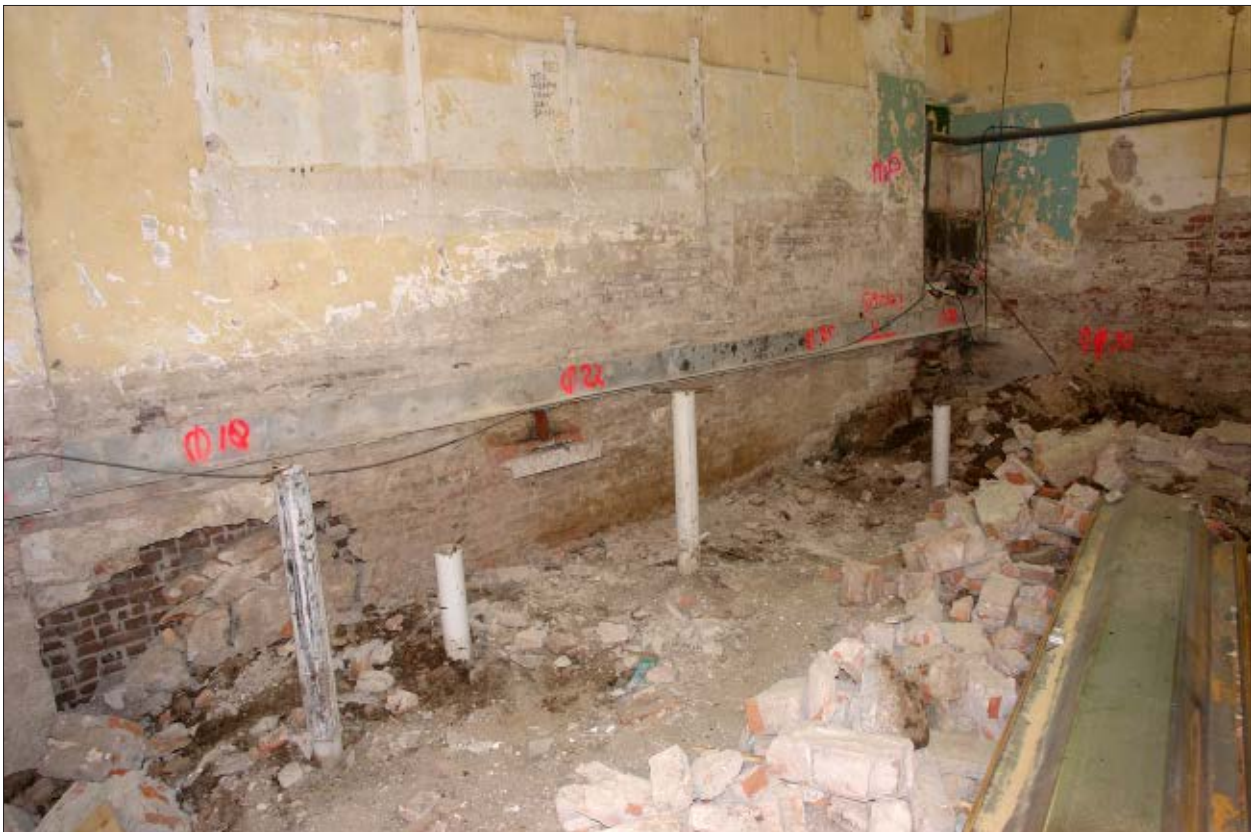
Afb. 4.13 Overzicht van de oostelijke zijgevel van het Schoonhuis, onder de stalen balk waar met rode verf op geschilderd is. De onderkant van deze balk bevindt zich op 5,00 m+NAP. Links is een deel van de funderingsboog ingestort en de muur van het buurpand uit de late negentiende-eeuw is erachter tevoorschijn gekomen. De foto is genomen naar het zuidoosten.
