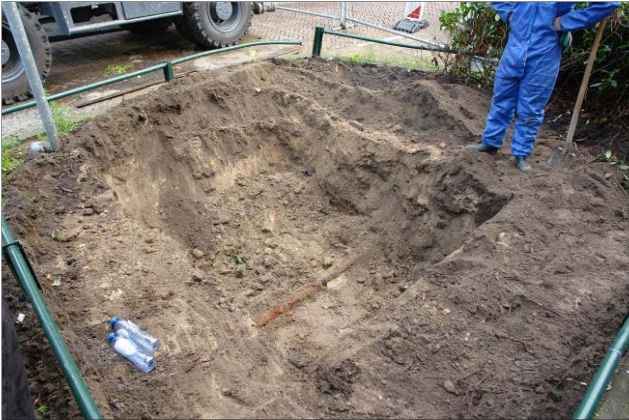
Afb. 3.3 De gietijzeren leiding die werd aangetroffen tijdens het graven van het putje in de Dirck van Zuylenstraat, gezien in noordwestelijke richting.
