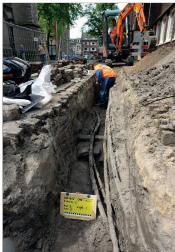
Afb. 2.3a Overzicht van werkput 2 met de rioolgoot (spoor 2) vanuit het oosten richting het westen.
